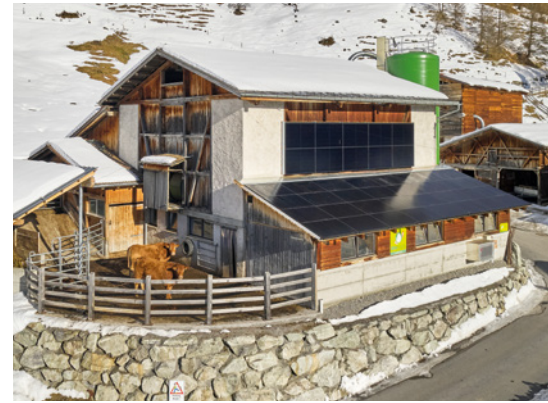
L'installation photovoltaïque de l'étable fournit même du courant en cas de fortes chutes de neige.
